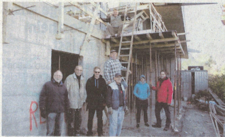
Eigenleistung beim Turnhallenanbau: (von links) Gerd Bekirsch, Peter Villing, Freddy Maletschek, Alex Kehrer, Karlheinz Höflich, Sabrina Fäth vom Büro Schuler und Schickling sowie Architekt Thomas Schuler.
